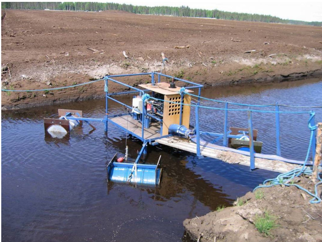
Kuva 14. Reijo Mäki-Kyynyn valmistama pumppauslautta varustettuna dieselpumpulla. Pumppu on omaa valmistetta, moottori Kubotan nelisynterinen dieselmoottori. Huomaa tukeva kävelysilta sekä turvakaiteet.
