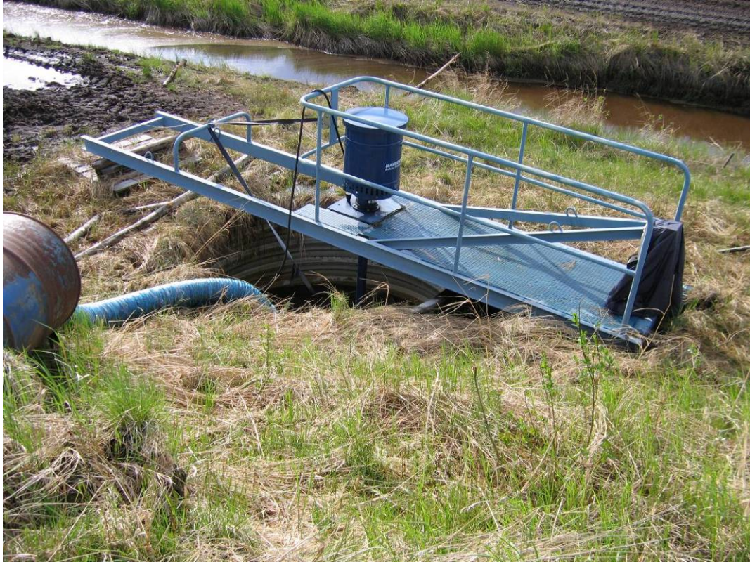
Kuva 12. Dieselaggregaattipumppaamon akselipumppu on sijoitettu pumppauskaivon päälle. Huomaa teline ja pumpun erilliset nostolaitteet (nostoliinat). Pumppu Mamec:in pengerpumppu ja CAT- dieselaggregaatti.
