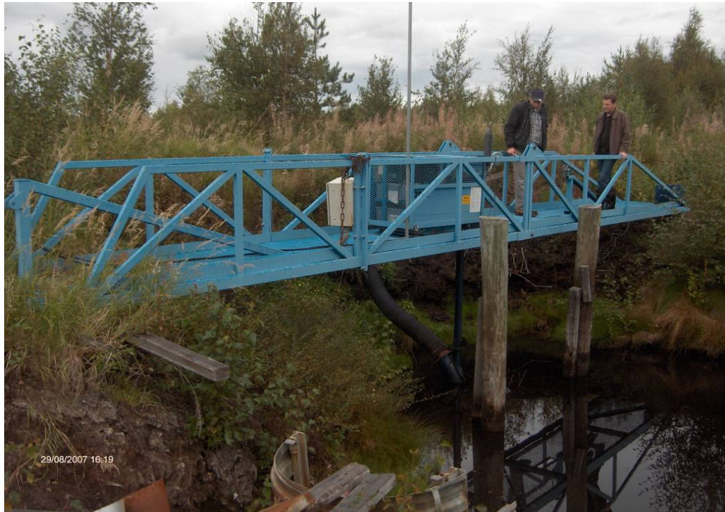
Kuva 16. Pumppausilta, dieselmoottori ja akselipumppu Turveruukki Oy:n tuotantoalueella.
