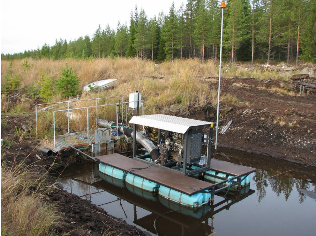
Kuva 15. Pudasjärven Turvetyö Oy:n valmistama pumppauslautta. Lautta on varustettu Kubotan dieselmootorilla ja Mamec:n pengerpumpulla. Huomaa hälytysvalo sekä ohjauslaitekaapin sijoitus (kuva: Pudasjärven Turvetyö Oy).
