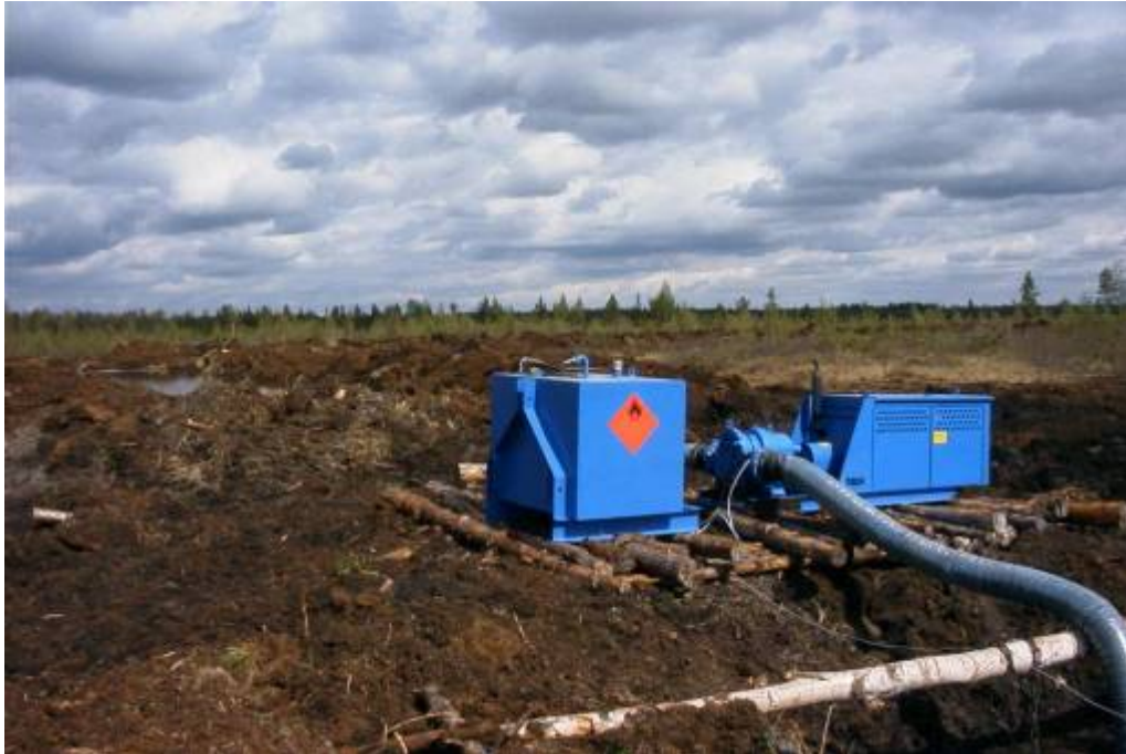
Kuva 19. Altaan reunalle on sijoitettu itseimevä roottoripumppaamo (kuva: Turveruukki Oy).
