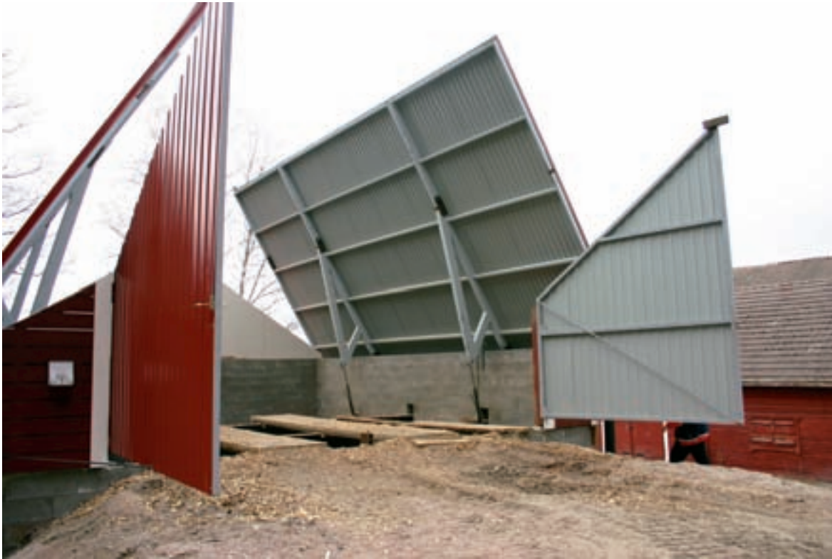
Brofeldt on suunnitellut hakelämpökeskuksen polttoainesiiloon kätevän ajosillan. Sen ansiosta siilon takaosakin on helppo täyttää.
