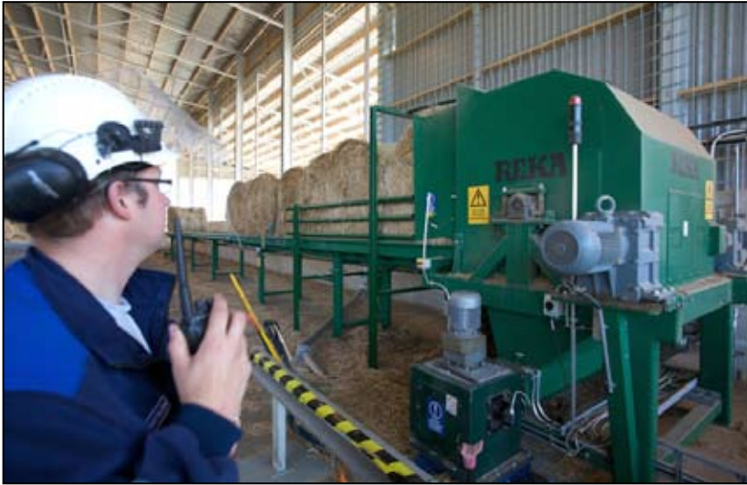
Hidaskäyntinen repijätyyppinen paalinmurskauslinja. Taka-alalla näkyy paalien syöttölinja, jolle paalit kuormataan ja joka syöttää ne murskaimen. (Kokkolan Voima Oy)
