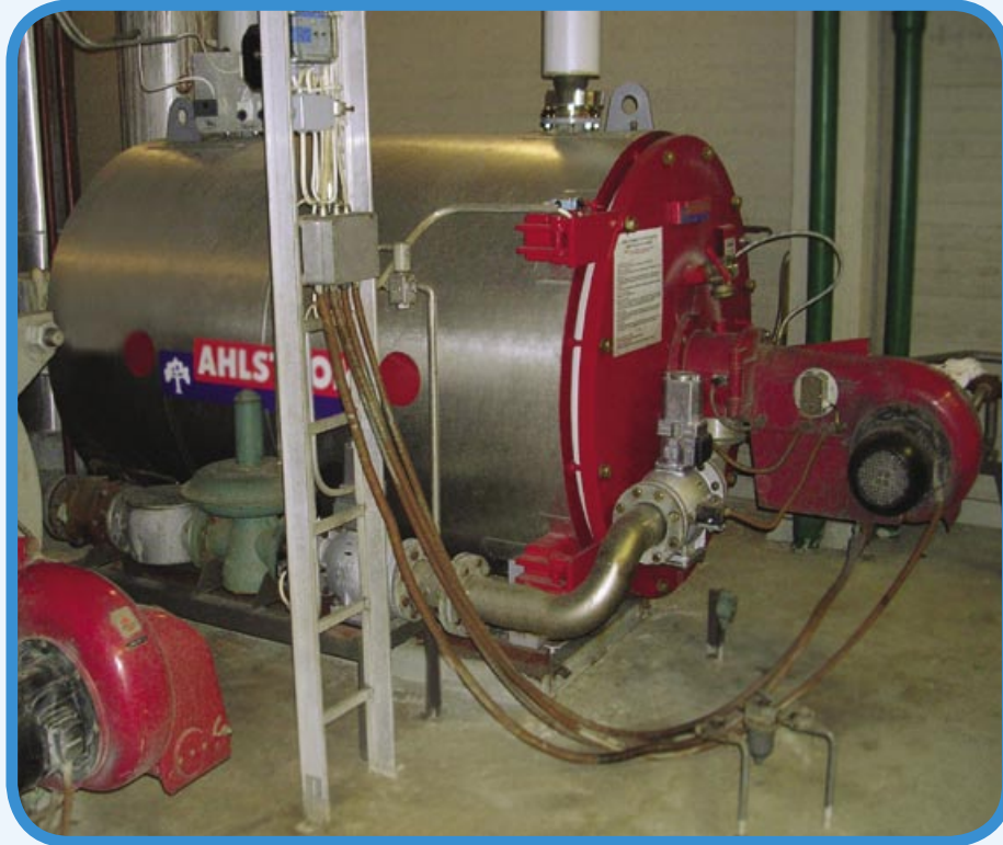
Lämpökattila Lahdessa, Kariniemen jätevedenpuhdistamolla.
