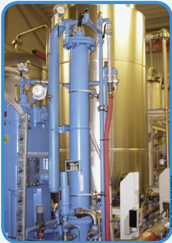
Biokaasun jalostuslaitos Tukholmassa, Bromman jätevesilaitoksella.
