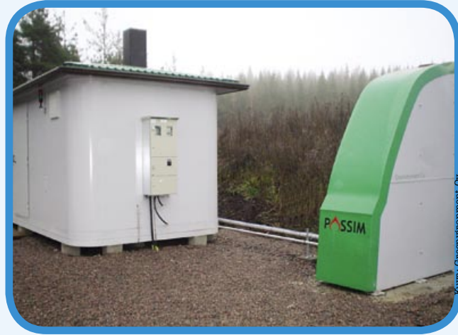
Mikroturbiinikontti ja soihtupoltin Stora Enson tehtaiden kaatopaikalla Imatralla.
