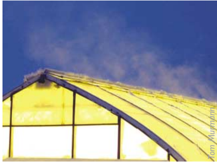
Rakenteiden lämpöhäviöt kasvattavat lämmitykseen käytettävien polttoaineiden kulutusta.
