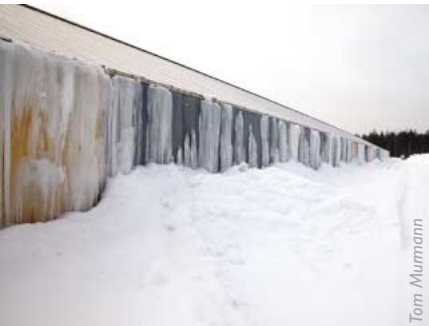
Suomen vaativissa ilmasto-olosuhteissa lämpöhäviöt kannattaa huomioida.
