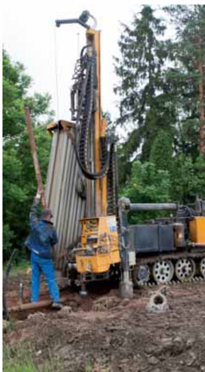
Ett borrhål är den vanligaste värmekällan för en markvärmepump.
