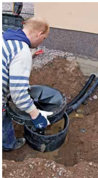
Inspektionsbrunnen kan täckas över med jord.
