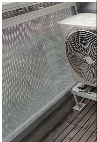
Kuva: Ilmalämpöpumpun ulkoyksikkö parvekkeella, Sampo Viitaharju
