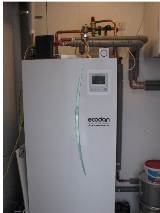
Kuva 5b Ilma-vesilämpöpumpun sisäyksikkö
