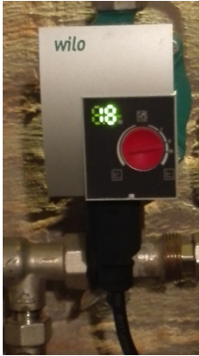
Kuva 3xx kiertovesipumppu vm-2017, jossa kierrosluku säätyy automaattisesti virtausvastuksen mukaan
