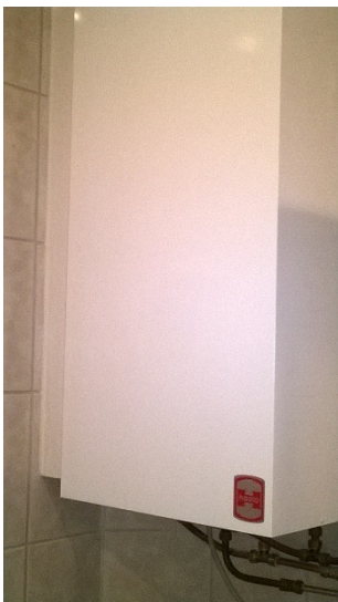
Kuva 2e 60-litrainen käyttövesivaraaja
