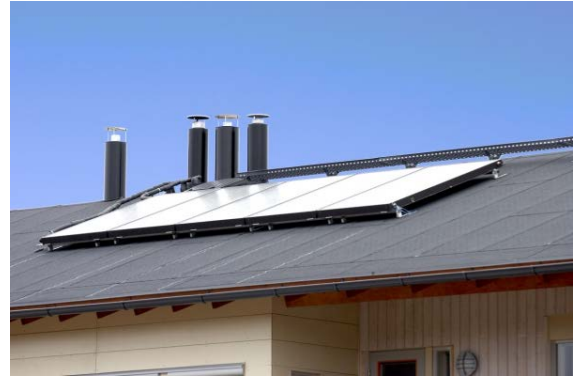
Kuva 2i Aurinkokeräimet talon katolla
