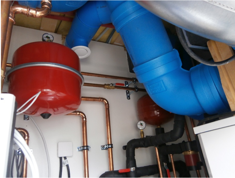
Kuva 6b Viilentävä tuloilmakanavisto on kondensioeristetty soluvieristeillä
