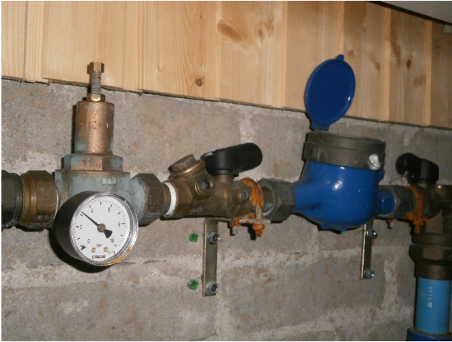
Kuva 2h Vesimittari ja paineenalennusventtiili
