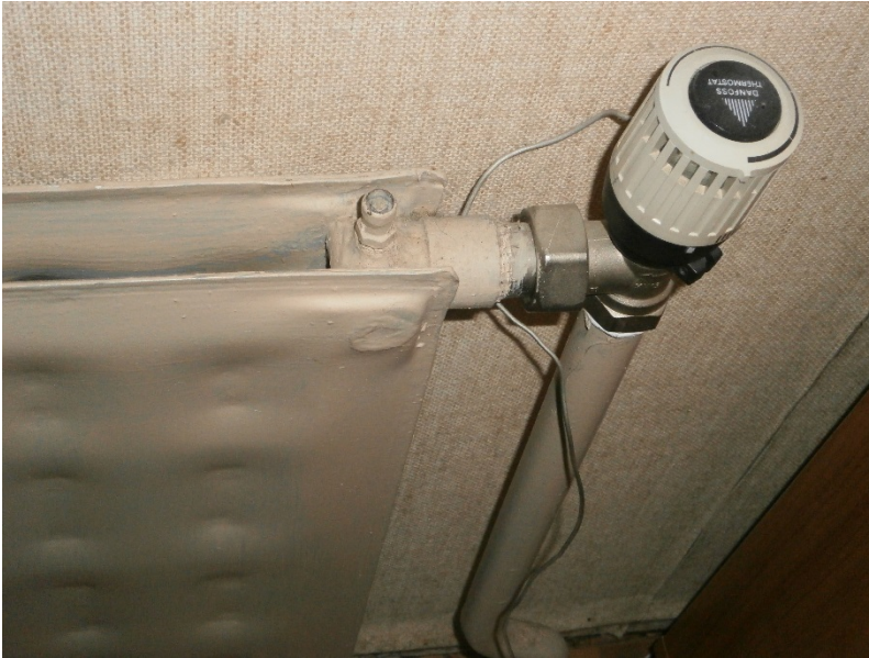
Kuva 3c Vanha vesipatteri ja patteritermostaatti
