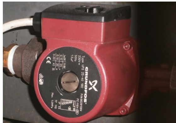
Kuva 3f kiertovesipumppu, vm-2009
