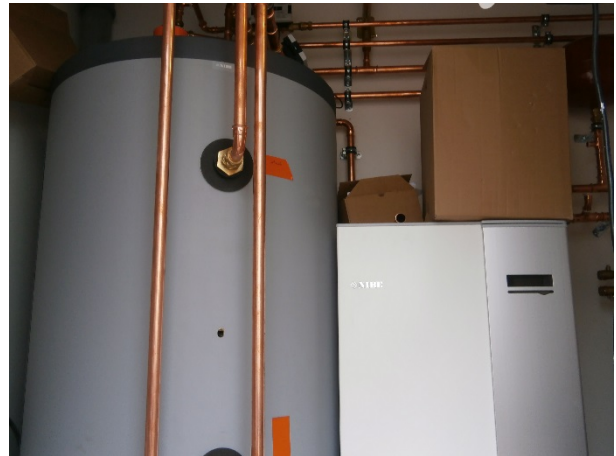
Kuva 6a Maalämpöpumppu sekä erillinen varaaja
