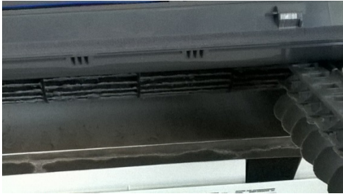
Kuva 4b Viiden vuoden aikana sisäyksikön puhaltimeen kertynyt pöly, jota ei saa pois kotikonsteilla
