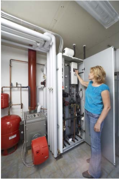
Kuva 2h Öljylämmitykseen kytketty aurinkolämpöjärjestelmä
