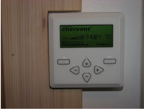
Kuva 9a Ilmanvaihtokoneen säädin
