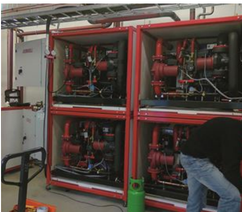
Kuva 6h 425kW:n maalämpöpumpputjärjestelmä, jossa 4 erillistä maalämpöpumpppua (lähde Gebwell)
