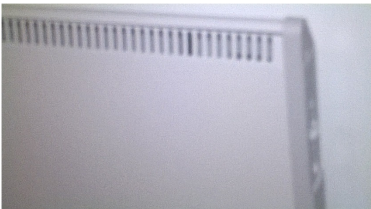
Kuva 3k Kuva nykyaikaisesta sähköpatterista
