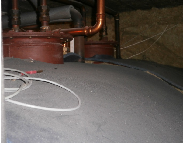
Kuva 2a 2 kpl yhteenkytkettyä 1500-litran lämmitysvaraajaa, joihin on jälkikäteen asennettu solumuovieristekerros päälle.
