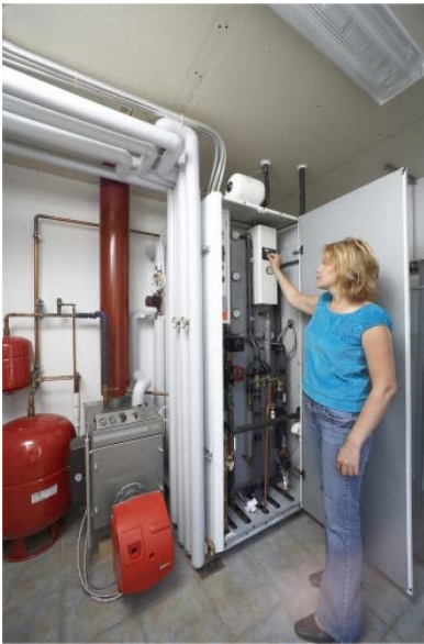
Kuva 2h Öljylämmitykseen kytketty aurinkolämpöjärjestelmä
