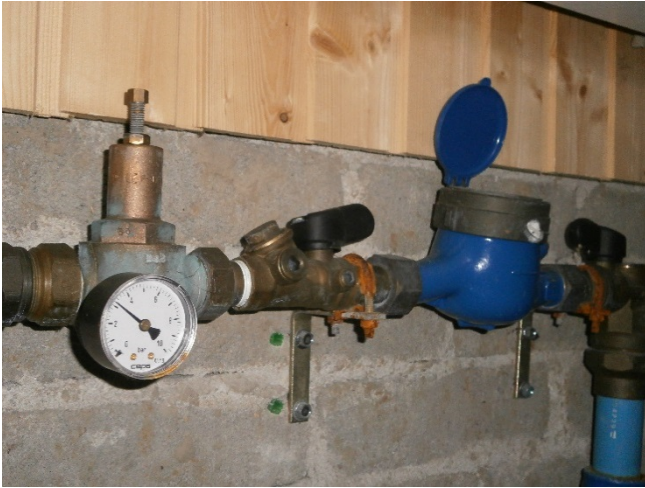
Kuva 2h Vesimittari ja paineenalennusventtiili
