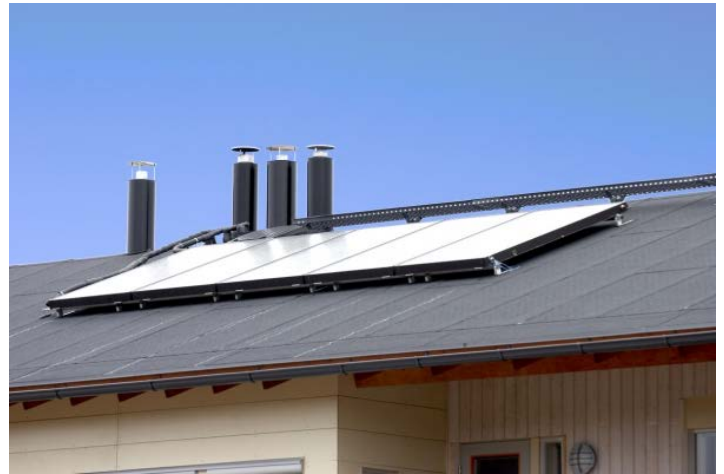
Kuva 2i Aurinkokeräimet talon katolla
