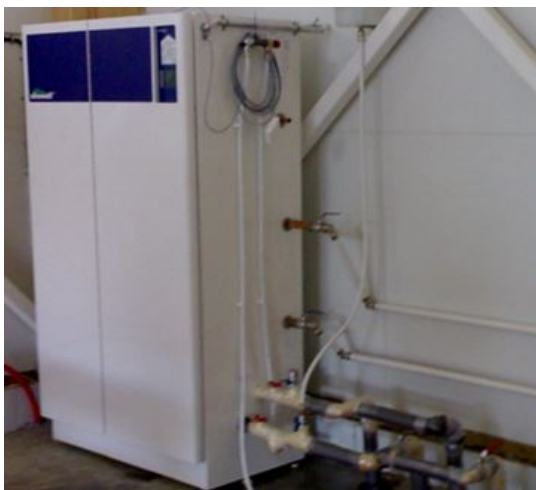
Kuva 6e Maalämpöpumppu integroidulla varaajalla
