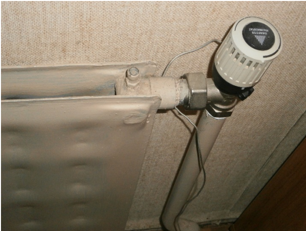
Kuva 3c Vanha vesipatteri ja patteritermostaatti
