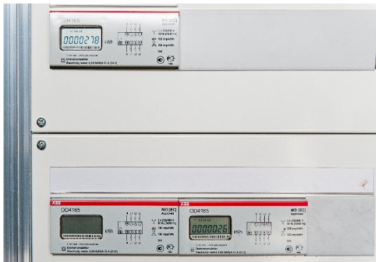
Kuva 1k Sähköenergian kulutusmittari, joka on integroitu rakennuksen sähköpääkeskukseen
