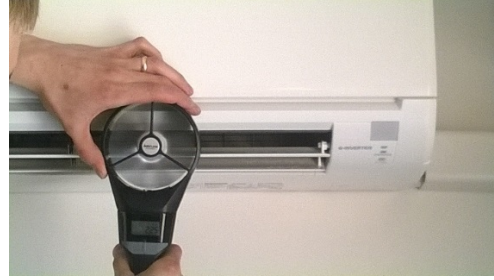
Kuva 4c Myös ilmalämpöpumpun puhallusteho parani merkittävästi ammattilaisen tekemän tehopuhdistuksen jälkeen.
