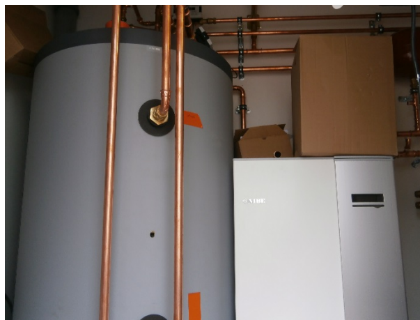
Kuva 6a Maalämpöpumppu sekä erillinen varaaja
