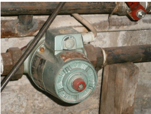
Kuva 3e Yli 40-vuotias kiertovesipumppu
