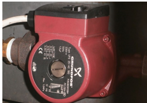
Kuva 3f kiertovesipumppu, vm-2009
